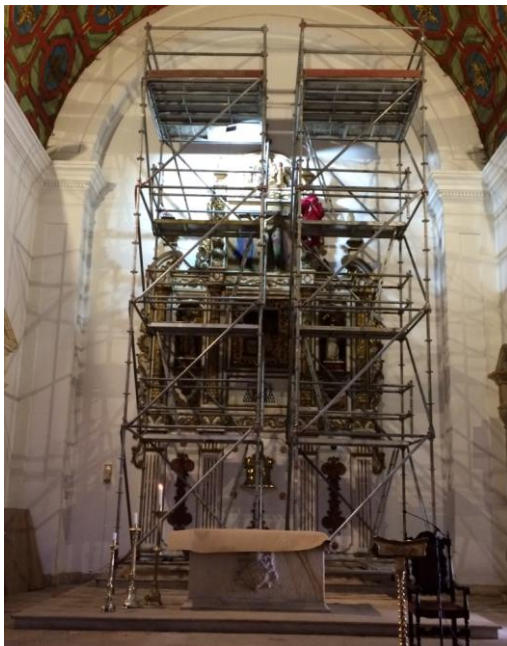
Fotografía 27. Estructura del andamio instalado en la Capilla.
